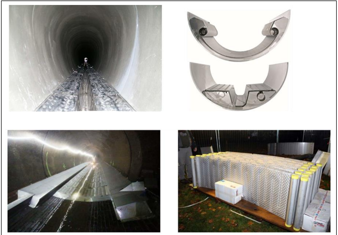
Abbildung 60: Abwasserwärmetauscher (Bildquelle: Fa. Uhrig (oben), Stadtwerke Aachen (unten))
